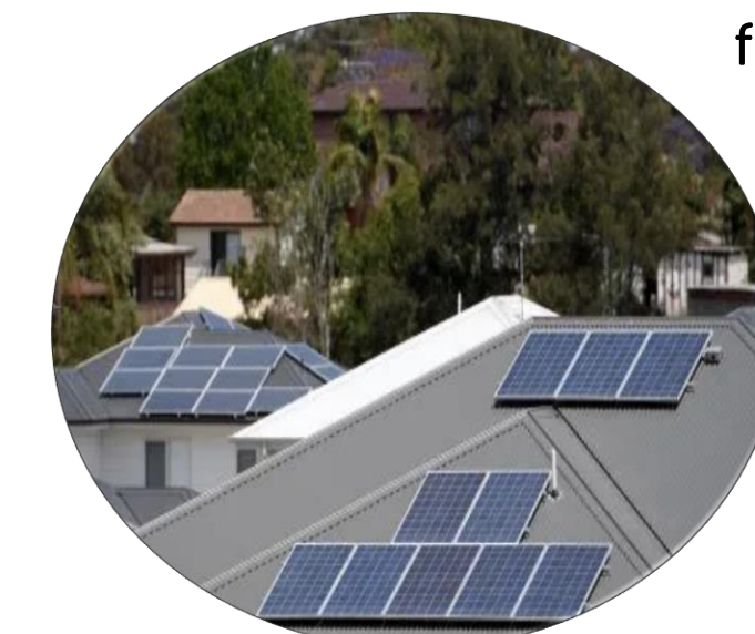
Sistema solar doméstico instalado
