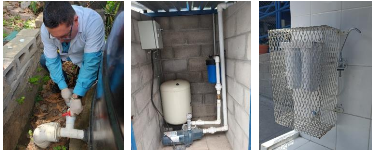
Fig. 2 Elementos de sistema de captación de agua lluvia en centros Escolares. Tanque de 10,00 litros, bomba y grifo con su respectivo filtro
