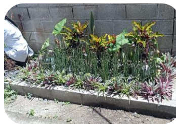
SISTEMA DE AGUAS GRISES BIOJARDINERAS
