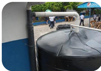
SISTEMA DE CAPTACION AGUA LLUVIA
