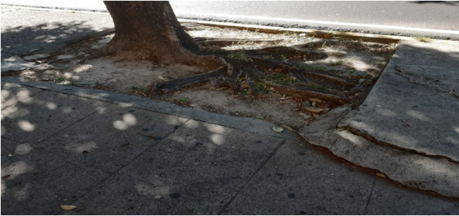
Figura 11. Daño de acera por raíces Swietenia humilis en la calle Rubén Darío
