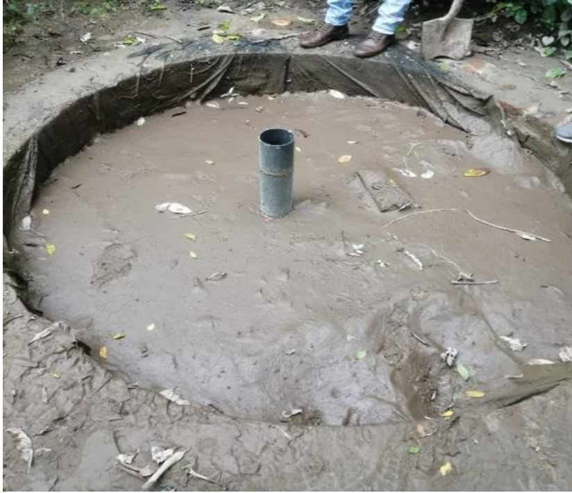
Figura 3.9. Acumulación de lodo sobre la superficie del pozo 4 después de una tormenta.
