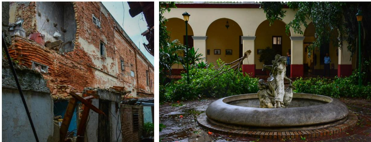
Figura 7. Impactos del huracán Irma en la ciudad de Camagüey. (Fuente: Adelante.cu)
